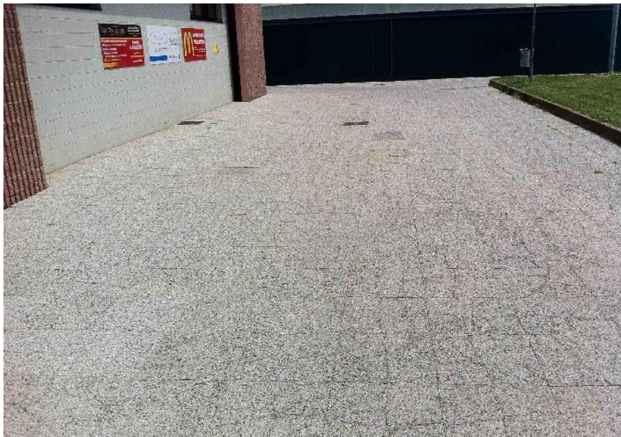
Figura 17: Pavimentazione esterna ammalorate vialetto accesso Bar
