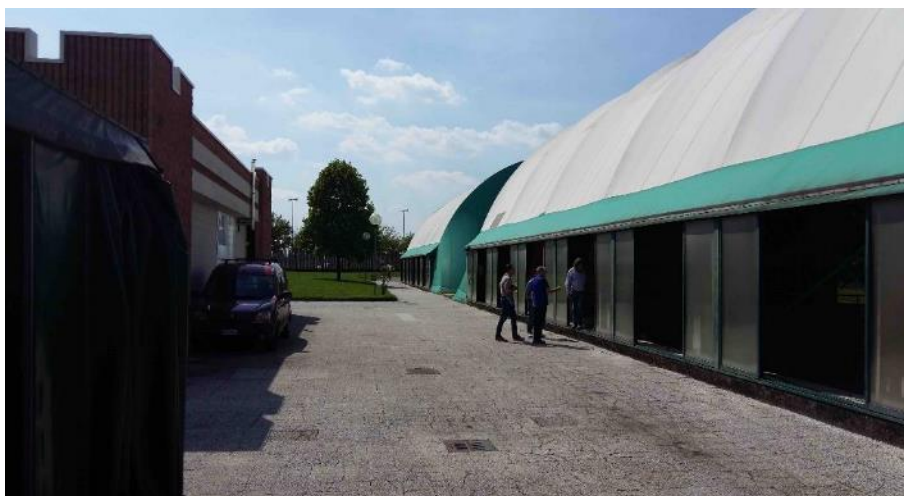
Figura 16: Pavimentazioni esterne ammalorate in corrispondenza campi tennis
